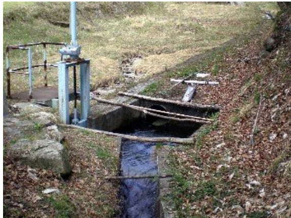
水源地の水門
