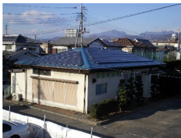
完成した住吉公民館共同発電所
